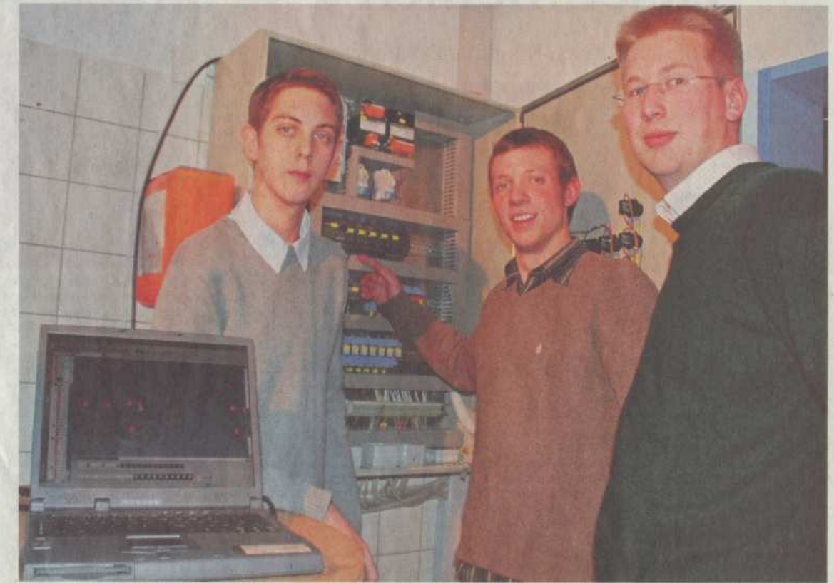
André Wichelmann, Björn Albersmann und Hendrik Knemeyer (von links) nehmen die neue Lüftungsanlage im Lackierraum in Betrieb. Mit 13 Mitschülern des Berufskollegs Warendorf haben sie sich an ihrer Entwicklung beteiligt. Foto: Schönherr
